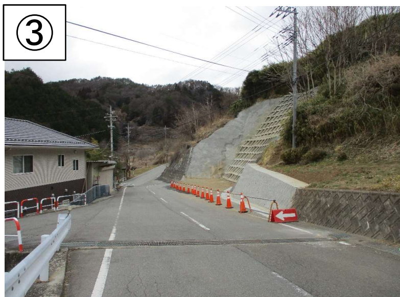
③ 現道の状況(一部法面工施工済み 地質脆弱箇所)
