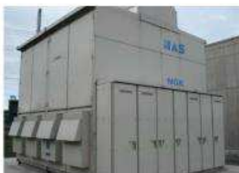
大型蓄電システム施設
