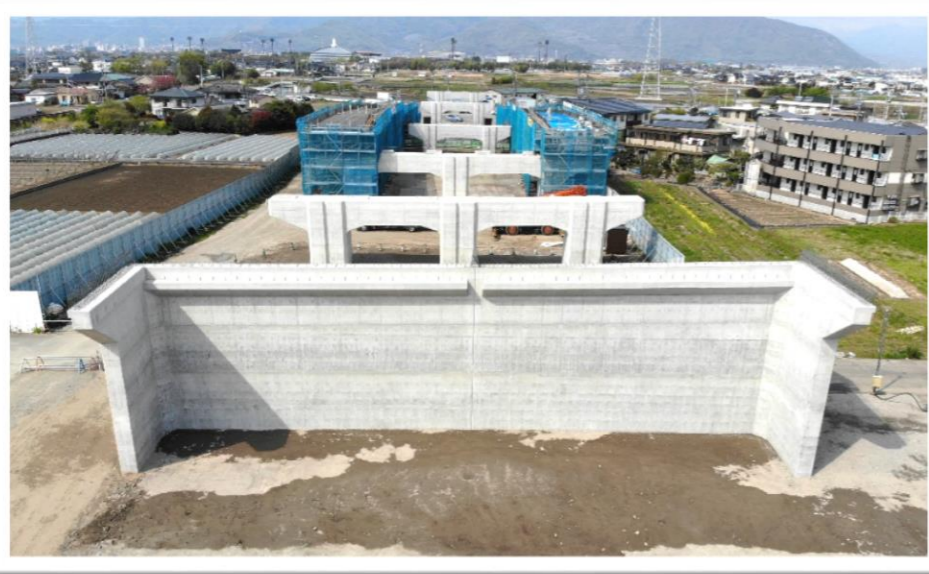
橋の土台部分を造るにあたりその周辺が弱い地盤である為地盤改良工事をしました。
