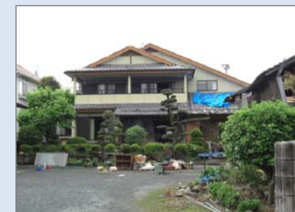
木造2階建て 被災状況
