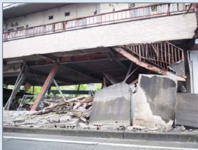
鉄骨造2階建て 被災状況
