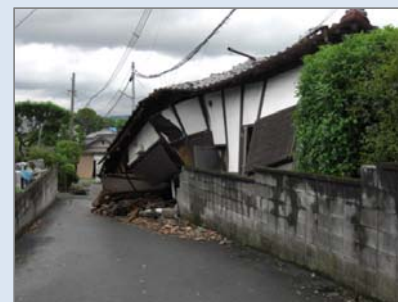
木造平屋建て 被災状況
