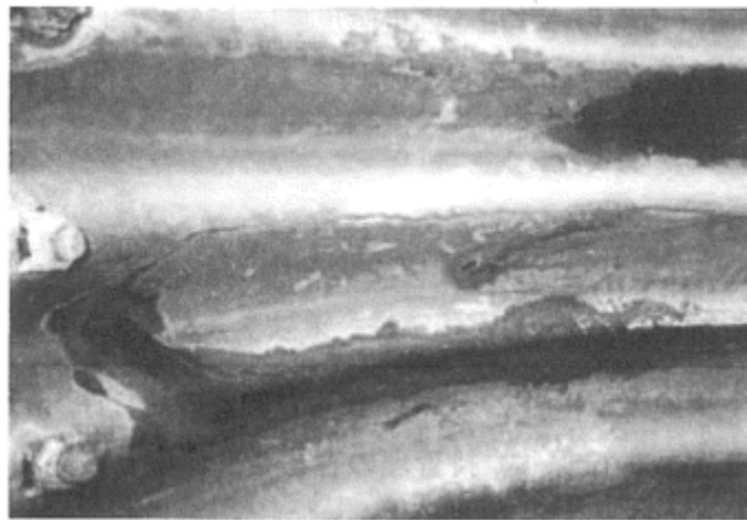
図-8.1.10 コルゲートメタルカルバートの腐食 (出典：道路土工—カルバート工指針(平成21年度) P19)
