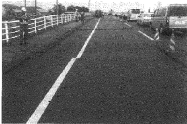
図-8.1.6 地震によりカルバート区間で発生した段差
