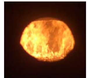
ボイラ燃焼の様子
