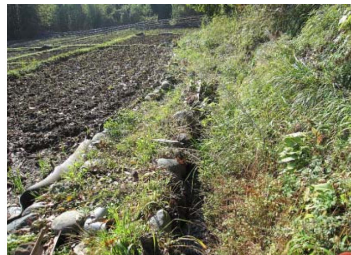
②未整備のため漏水が多く、用水供給が困難な農業用水路
