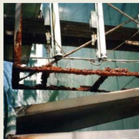
袖看板の底部脱落
