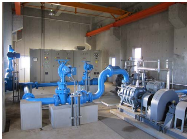
配水施設・電気施設
