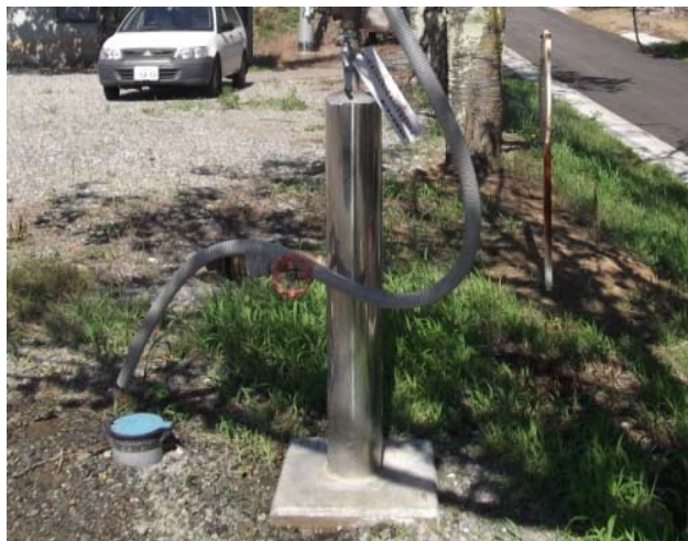
地域給水栓による灌水
