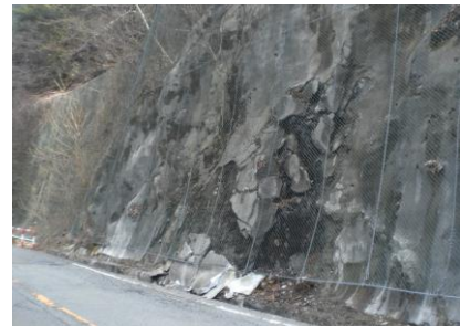
③現道法面(モルタル吹付)の劣化状況
