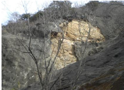
④法面上部のモルタル剥離
