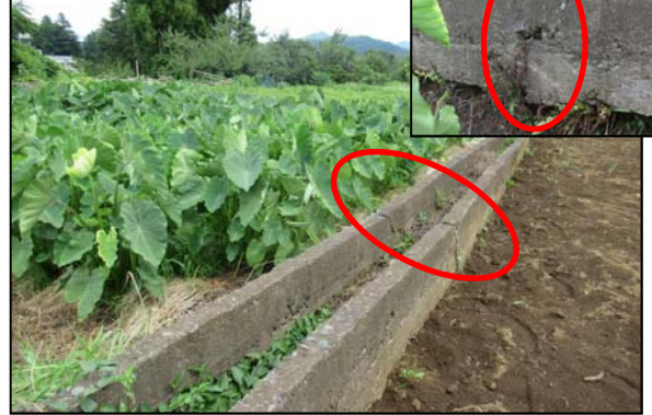
破損している水路
