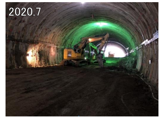
トンネル インバート工施工状況 (下八木沢第一トンネル)
