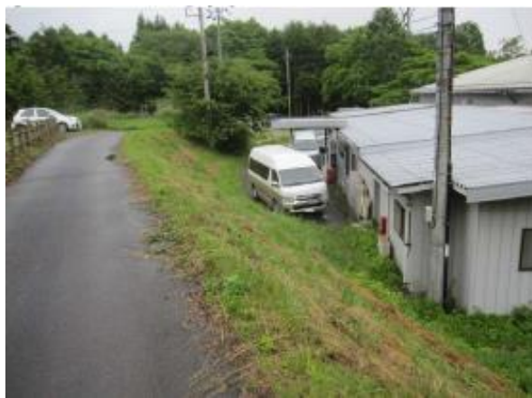
⑥ ため池直下には工場や人家があり、大規模地震の際には甚大な被害のおそれがあるため、早急に対策を講じる必要がある。
