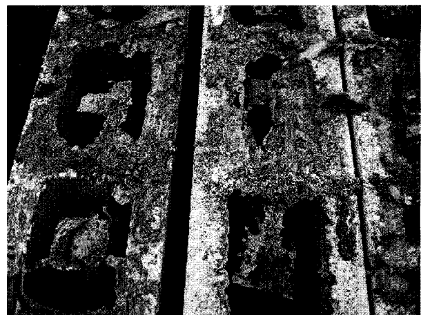
図2 蟻害を受けた誘蟻杭と蟻土
