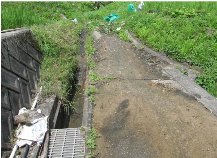
①幅員が狭い農道のため、農業機械の通行に支障が生じている。
