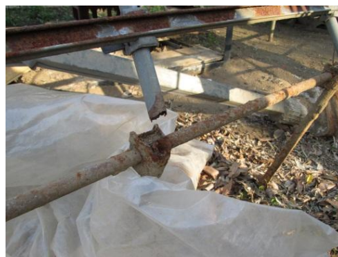
地際部の腐食による折れ
