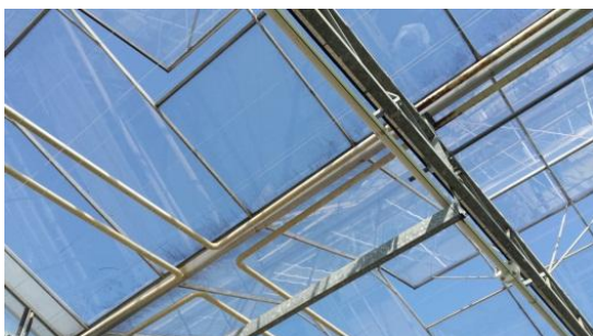
谷樋に設置された温湯配管
