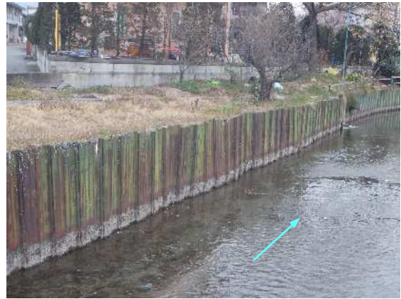
護岸の老朽化
