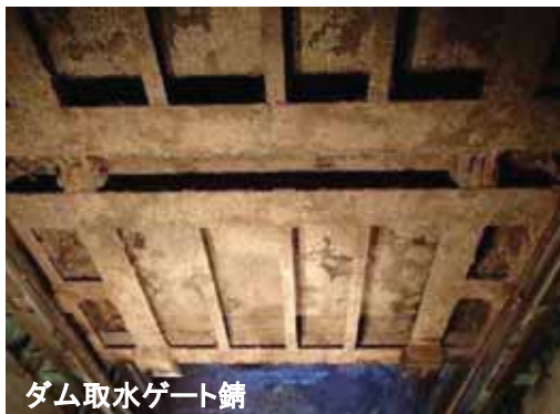
水門開閉装置の老朽化
