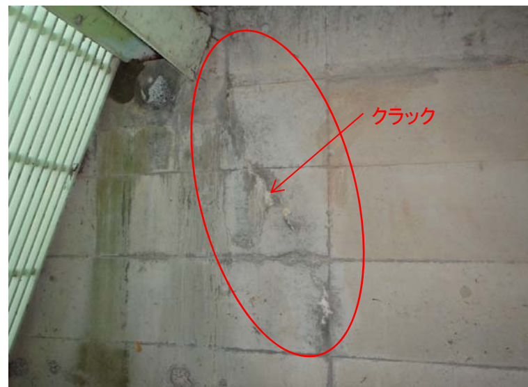
②排水機場基礎部に発生しているひび割れの状況
