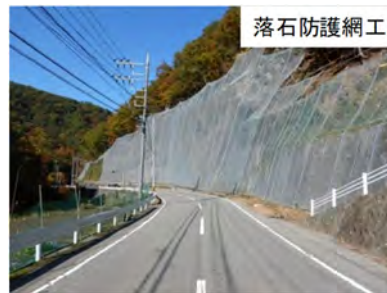
写真 法面对策(落石)
